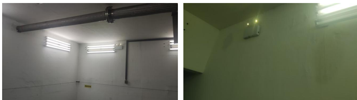
图4-5 1#加速器生产调试机房应急照明
