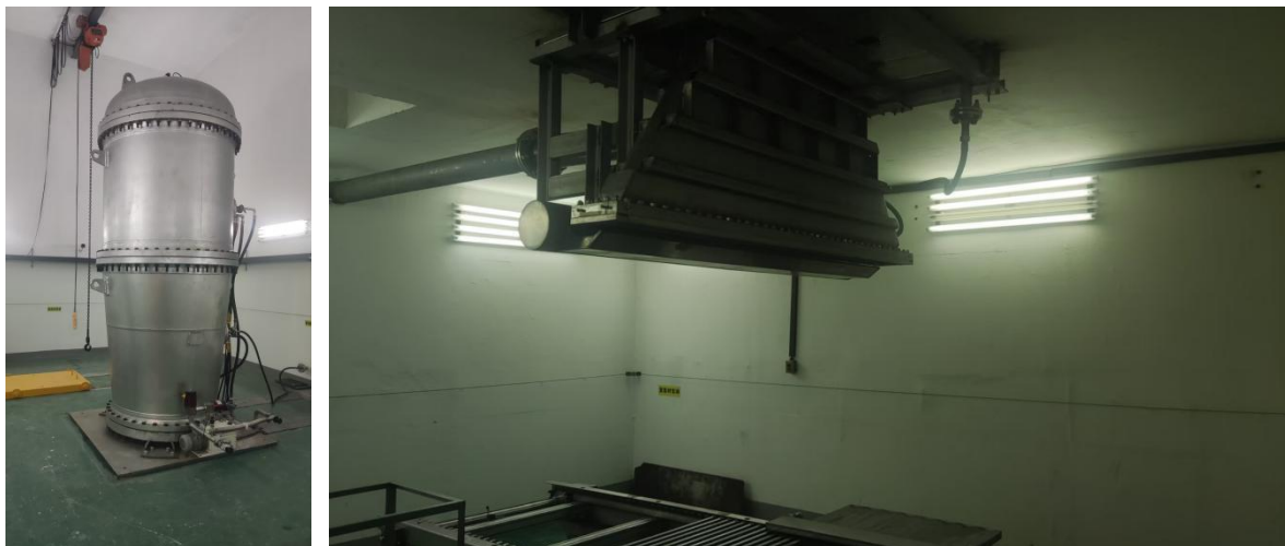
图4-1 1#加速器生产调试机房工业电子加速器
