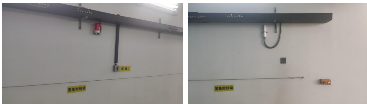
图4-3 1#加速器生产调试机房巡检按钮、拉绳开关、急停按钮、工作状态指示灯及固定剂量探头
