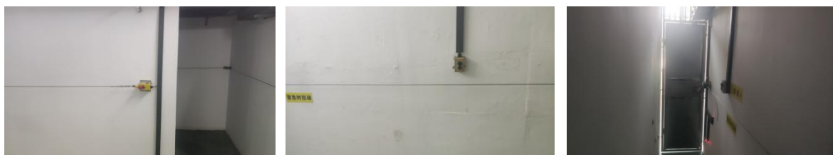
图4-4 1#加速器生产调试机房巡检按钮及拉绳开关
