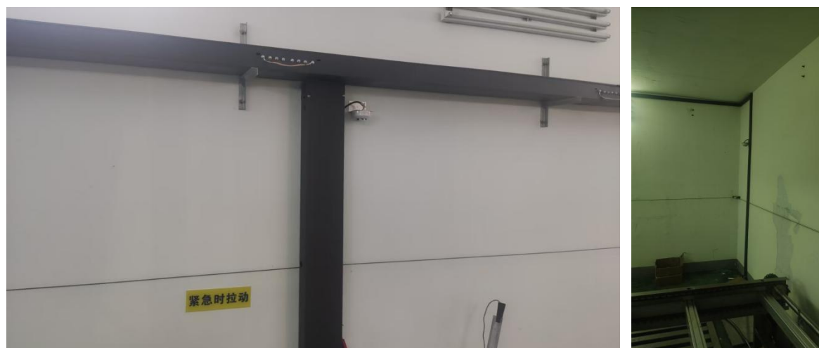
图4-6 1#加速器生产调试机房烟雾报警
